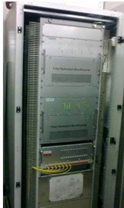
Die Geräte: mit den barox LWL-Modulen werden die Videosignale über grosse Distanzen übertragen.
