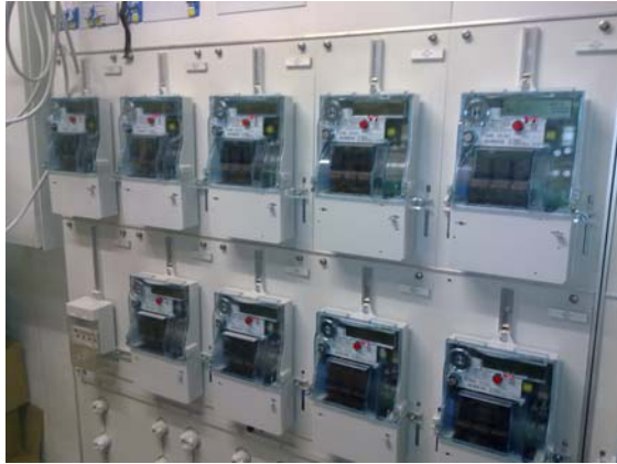
Smart Meter, die intelligenten Stromzähler, in einer Installation in einem Mehrfamilienhaus
