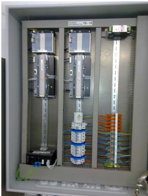
Installation in einer Trafostation (barox Switch links unten im Bild)
