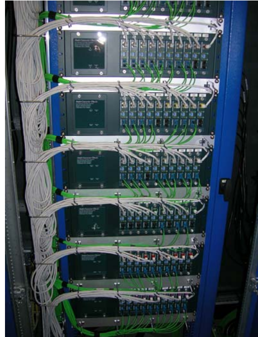
Die Medienkonverter in der Netzzentrale empfangen die Messdaten der Verbraucher
