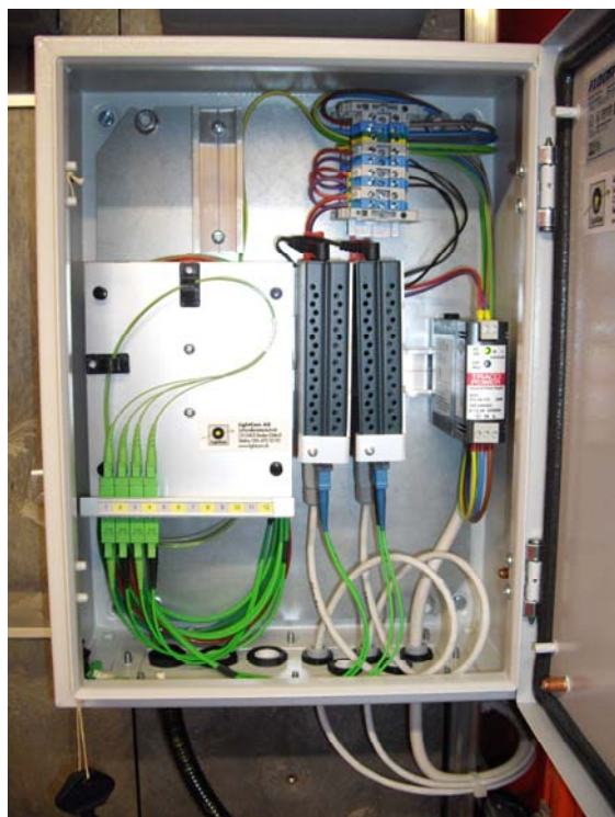
Installation bei einem Grossbezüger in Spreitenbach
