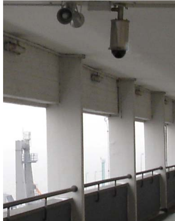
Die Videoüberwachung umfasst Innen- und Aussenräume
