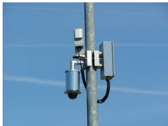
Fig. 1: Caméra disposée sur pylône avec émetteur S1100
